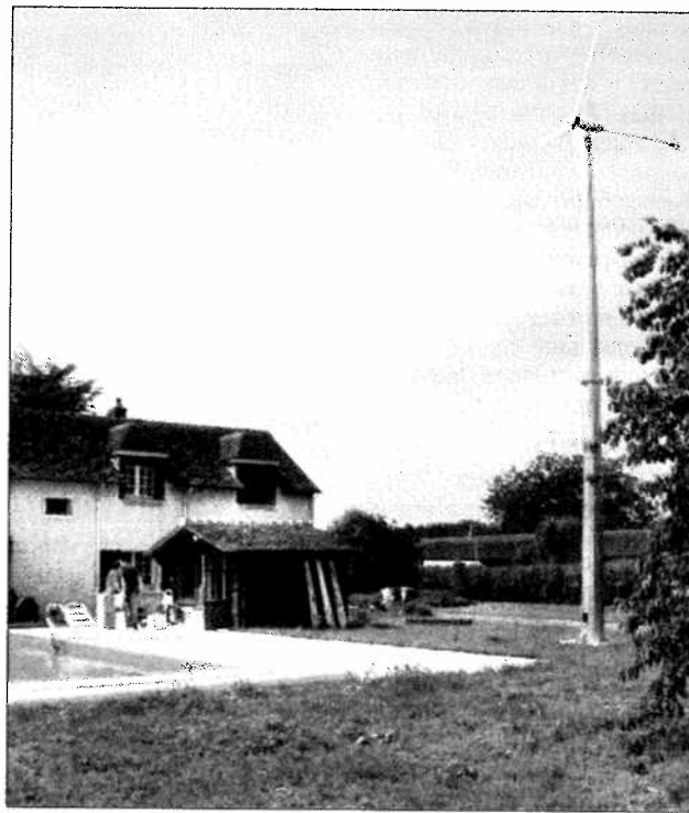
Les éoliennes fournies par la société France Éoliennes ont connu beaucoup de difficultés, en raison de leur mauvaise qualité.
